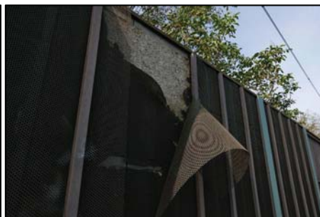
Obrázek 5. Poškození – klimatické podmínky (foceno 2. 10. 2020) [zdroj: ČVUT]
