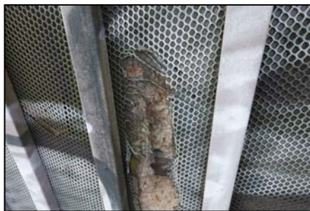
Obrázek 2. Vandalské poškození – zapálení (foceno 2. 10. 2020) [zdroj: ČVUT]
