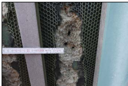
Obrázek 4. Poškození – vyklování ptáky (foceno 2. 10. 2020) [zdroj: ČVUT]
